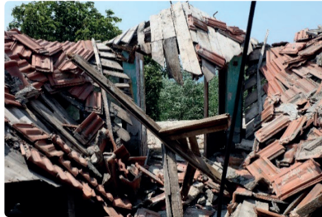
Şekil 7.9. Çatı elemanında malzeme bozulmasına bağlı deformasyon ve göçme.
