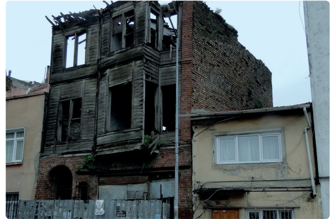
Şekil 4.9 Yangın görmüş ahşap yapı (Z. Ahunbay).
